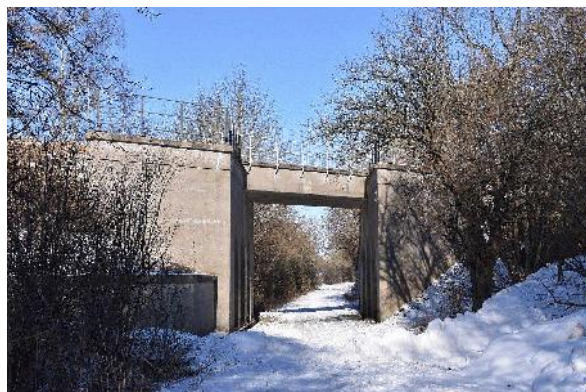
Nystedbanens underførsel under Fugleflugtslinjen set fra Flintinge i retning Toreby T i km 32,6 fredag 12. februar 2021 .
